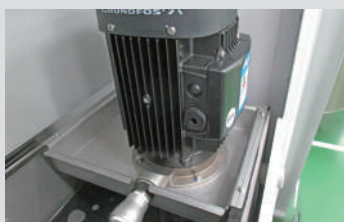
⑦水漏れ確認
