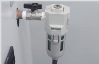
⑦ドレントラップ動作確認
