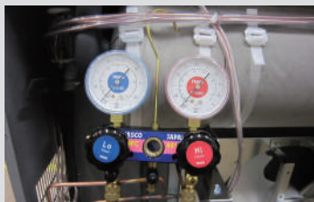
④冷媒圧力測定
