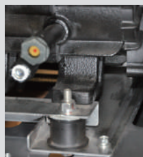
⑨オイル漏れの確認
