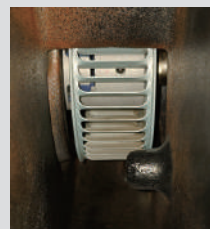
⑩カップリングエレメントの 異常・亀裂の確認
