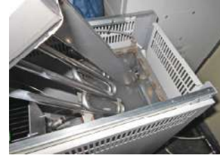
③加湿機の確認
