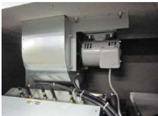
⑦モータ類の異常音確認
