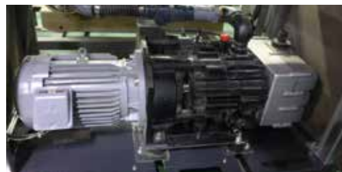
清掃後の 真空ポンプ
