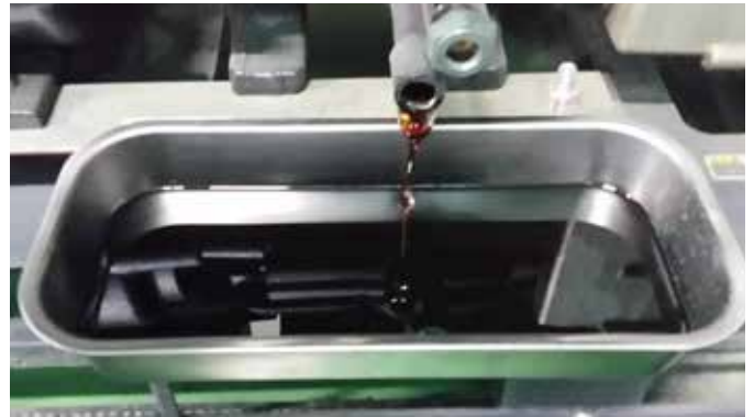
15,000Hr 稼動オイル (黒く変色劣化あり)
