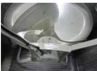
⑧モータ類の異常音確認
