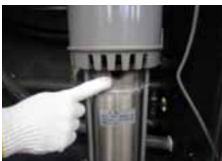
⑦水漏れ確認
