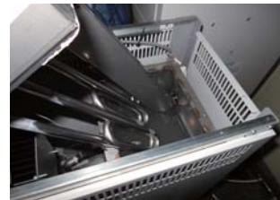
③加湿機の確認
