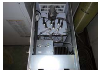
⑧ヒータ、フロート動作確認
