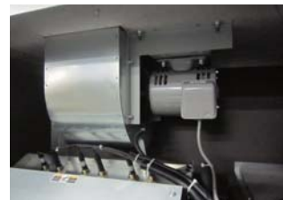
⑦モータ類の異常音確認
