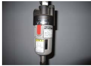
⑩ドレントラップ動作確認
